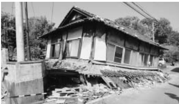
熊本地震での被害状況
