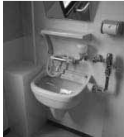
必要とされる オストメイト対応トイレ
