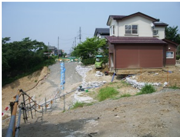
図-4.6 地震による造成宅地の被害の例
