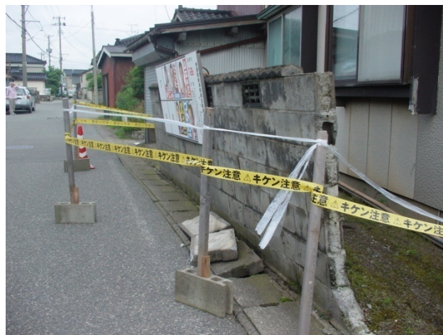
図-4.5 地震によるコンクリートブロック塀の倒壊の例
