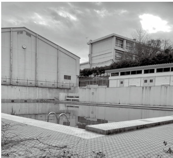
老朽化した中学校プール
