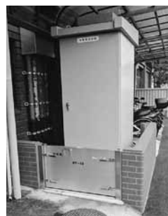
役場庁舎に設置された防水壁
