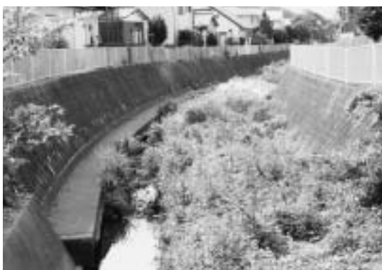
浸食された護岸の基礎の修復と河床整理が求められる葛川
