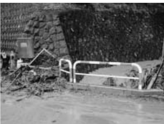
ウサギ沢 流木がカルバートを塞ぎ道路に冠水
