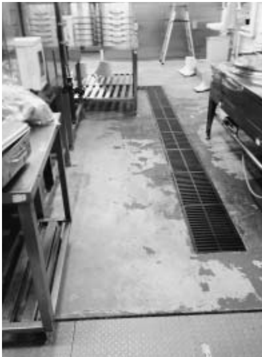
老朽化が目立つ給食センター調理室
