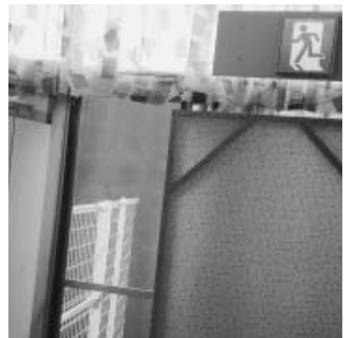
こども園・避難口外にある扉には南京錠
