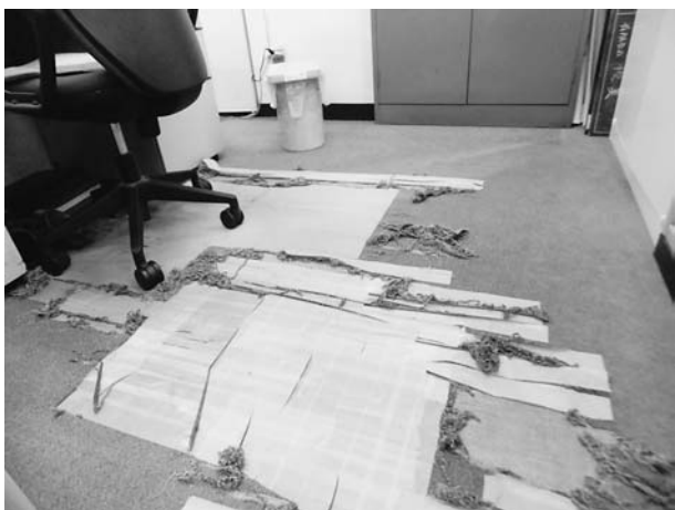
ボロボロな改善センター内事務室
