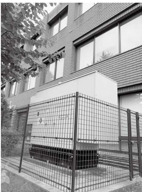
庁舎設置の発電設備
