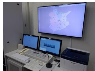
※H29 に整備した操作卓 （防災行政無線デジタル化）
