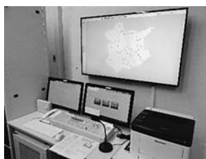
H29に整備した操作卓 (防災行政無線デジタル化)
